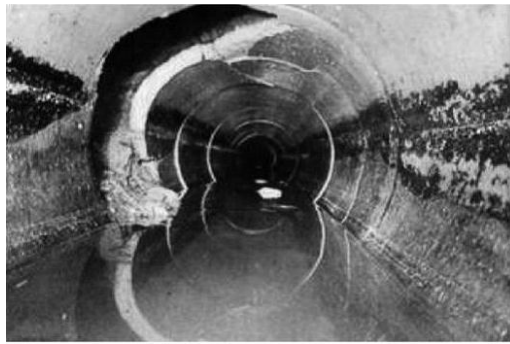
(b) 管道漏洞
