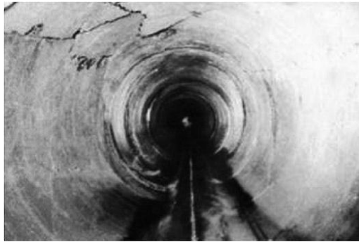
(a) 管道裂缝
